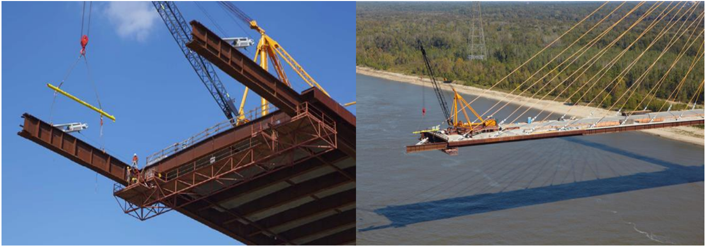
Ejemplo del método de construcción en voladizo: John James Audubon Bridge, Baton Rouge, Louisiana
